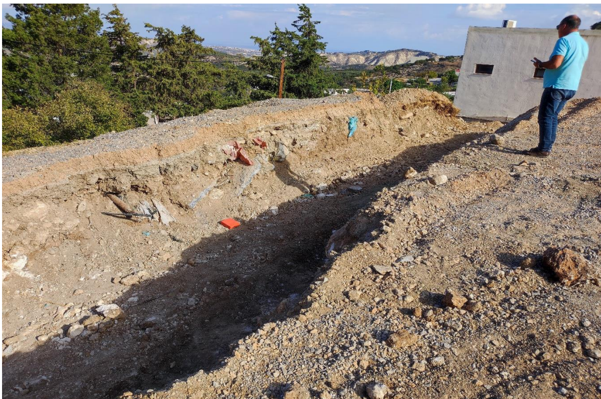
( Φώτο 2) σκουπίδια και μπάζα στη στάθμη θεμελίωσης .
