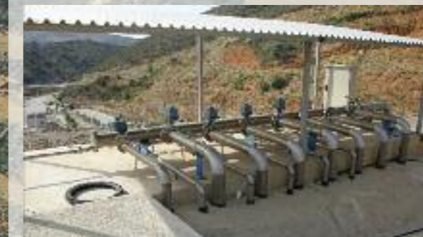
Υποσταθμός βιαερίου για ανακυκλοφορία Νέου κυττάρου
