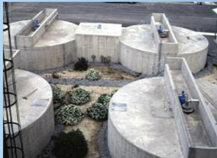
Βιολογικός καθαρισμός - Δεξαμενές παχύνσεως λάσπης
