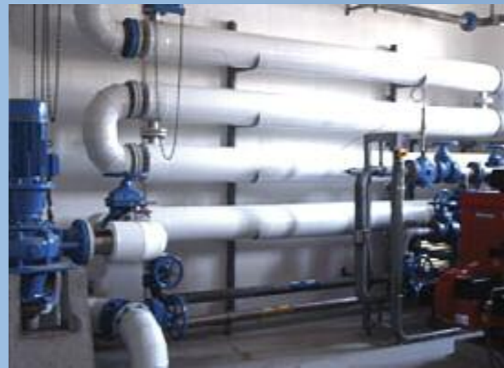
Βιολογικός καθαρισμός - Εναλλάκτες θερμότητας
